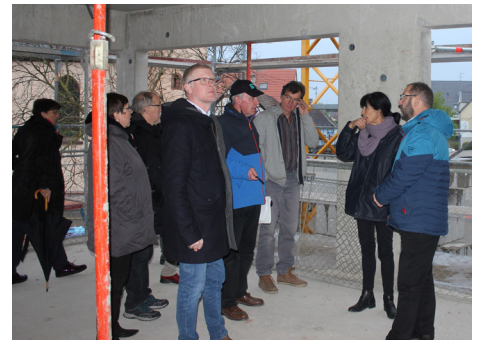
16 avril : visite des membres du Conseil municipal du futur bâtiment communal d'Ohnheim
